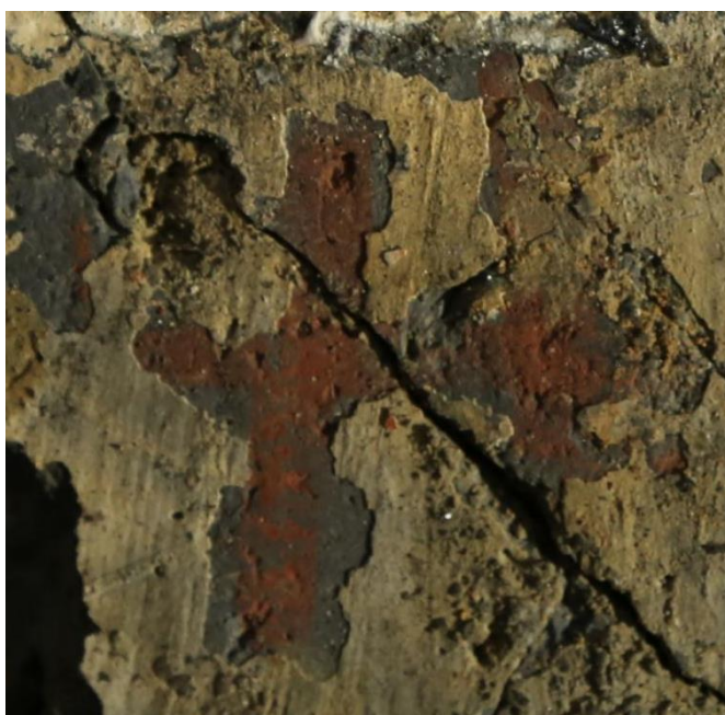
因墙体失去稳定性，向外倾斜。
