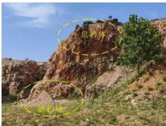
照片 3-34 边坡危岩体
