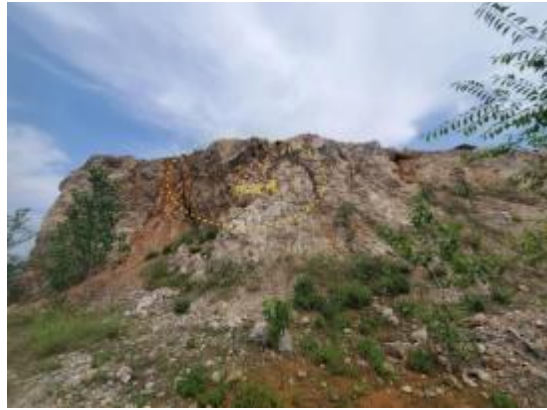
照片 3-32 边坡危岩体
