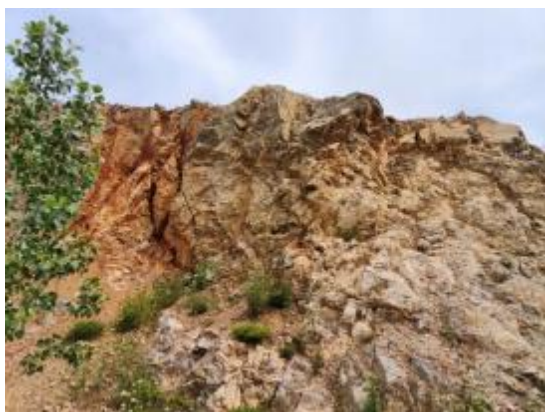
照片 2-3 边坡岩体局部较破碎
