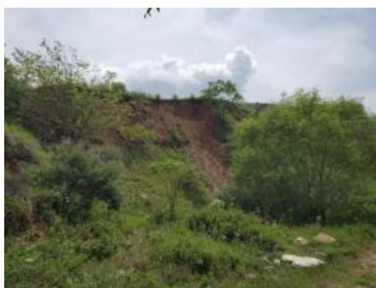
照片 2-4 边坡上部松散层
