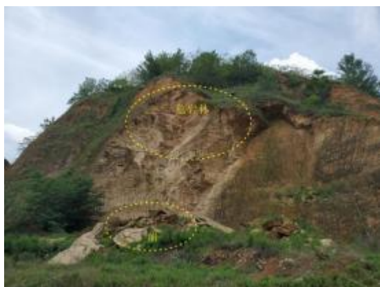
照片 3-21 崩塌全貌
