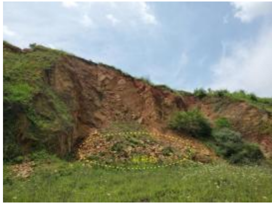
照片 3-26 边坡危岩体及崩积物
