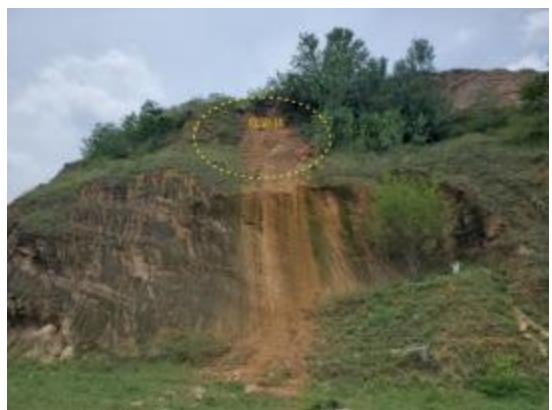
照片 3-23 边坡上部危岩体
