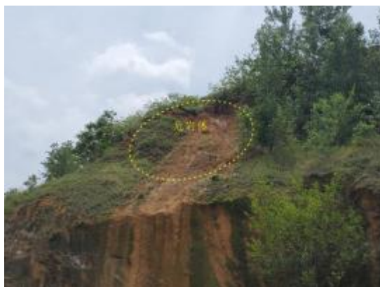
照片 3-24 边坡上部危岩体
