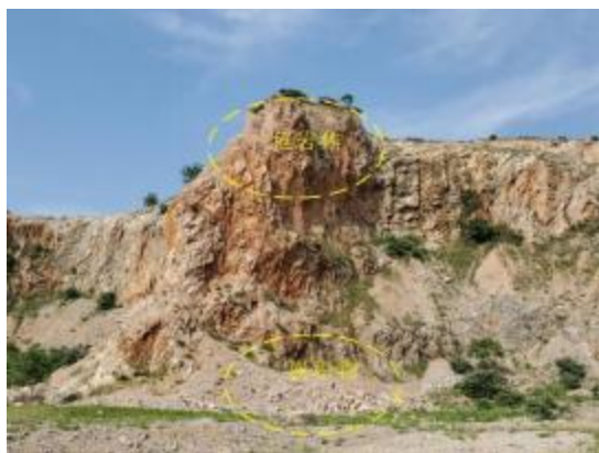
照片 3-33 边坡危岩体
