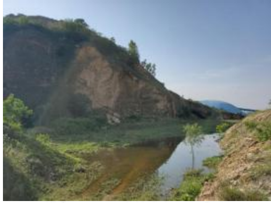
照片 3-14 边坡南部局部临空
