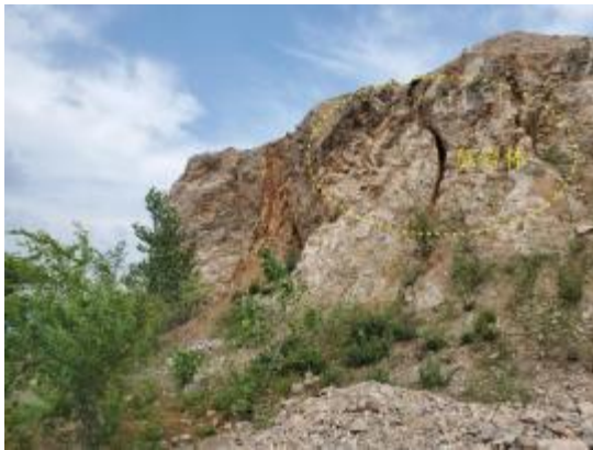
照片 3-31 边坡上部危岩体及裂缝
